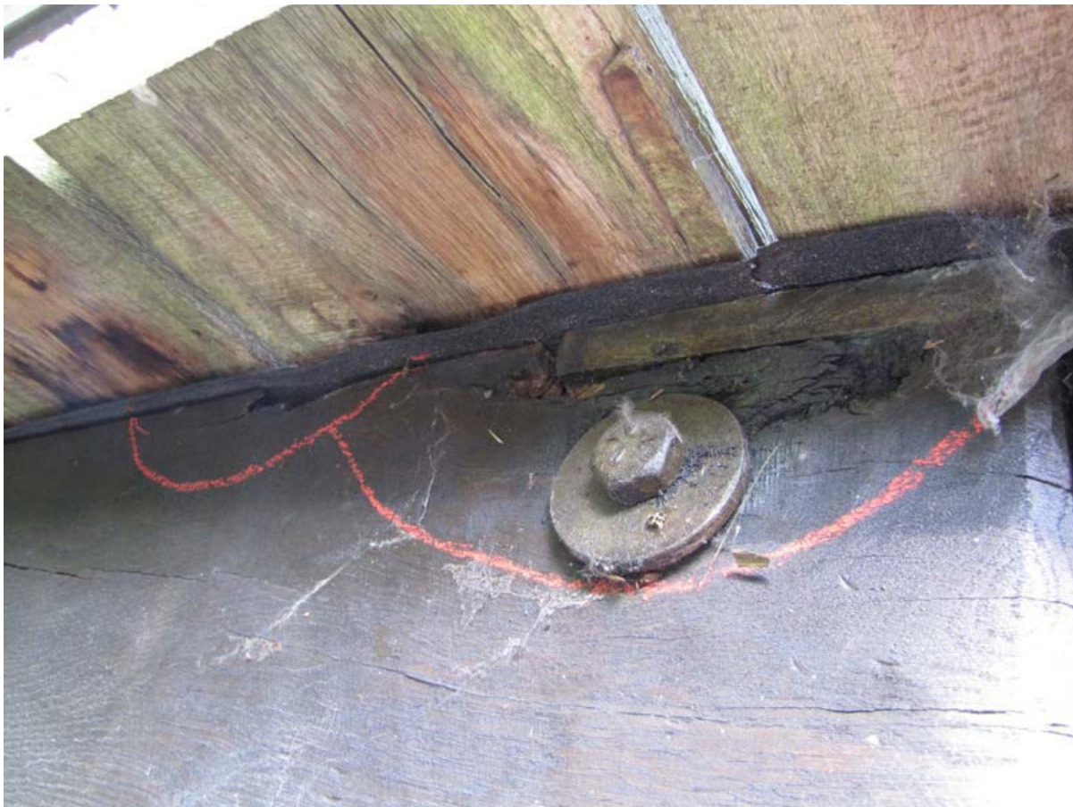
Bild 9: Schädigung der Oberfläche im Bereich des Knotenbleches
