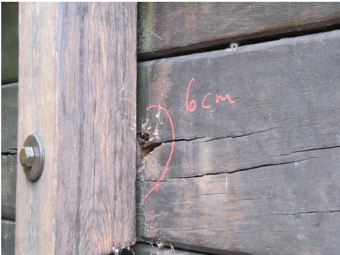
Bild 5: Substanzverlust bei 60 mm im Hauptträger
