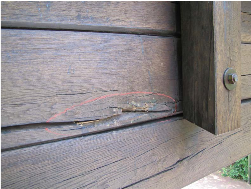
Bild 11: Längsrisse verläuft durch einen Asteinschluss
