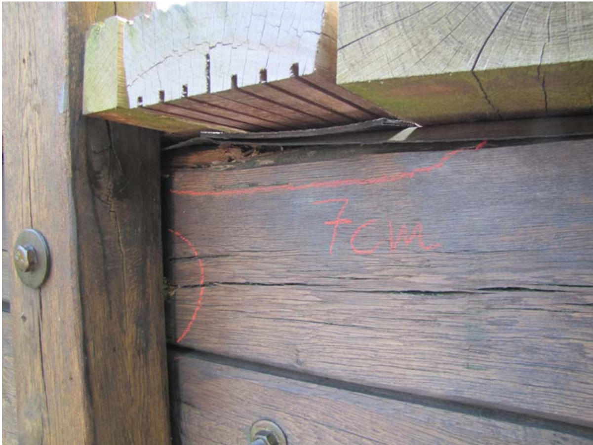
Bild 7: Die Schädigungstiefe auf der Oberfläche reicht bis 7 cm unter die Bohle
