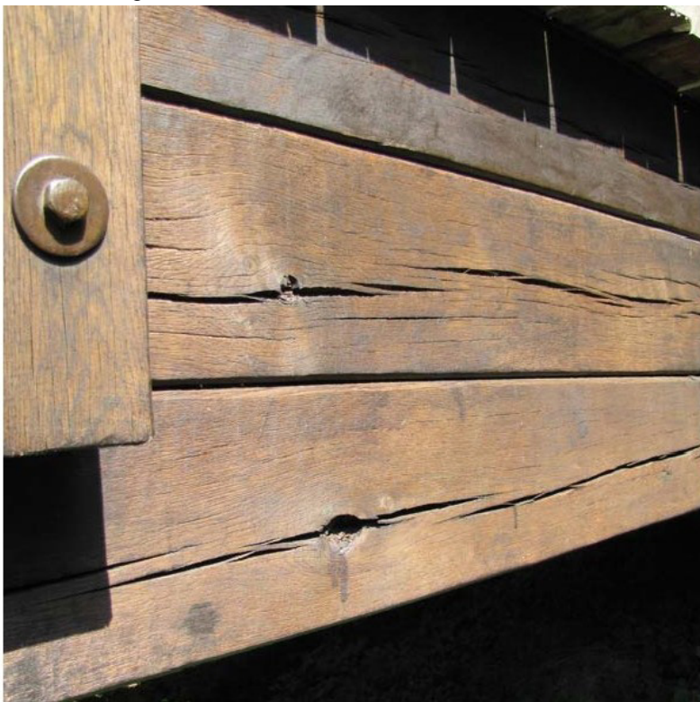
Bild 12: Risse in allen drei Hauptträgerbalken
