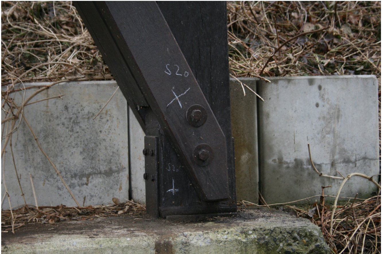
Bild 46: Lage der Bohrungen S20, S30 am Stützenfuss
