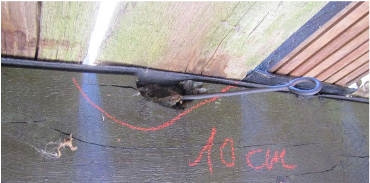
Bild 2: Astloch im Hauptträger, oben, unter dem Belag, Tiefe ca. 10 cm
