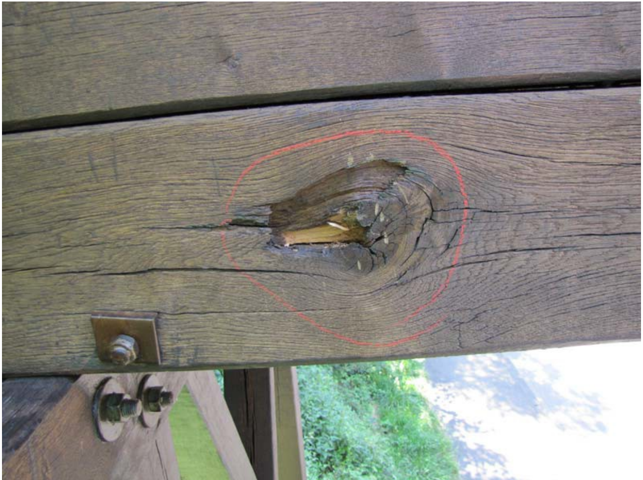
Bild 3: Astloch im Bereich der mittleren Stütze
