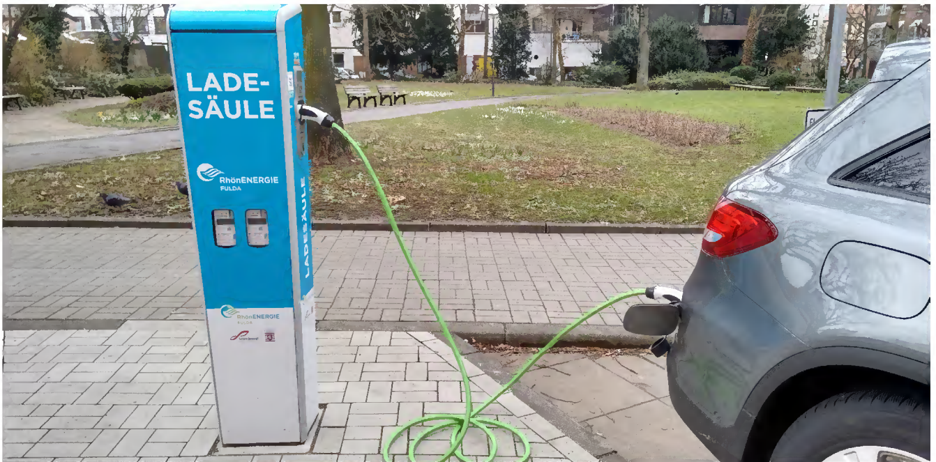
Beispiel für eine E-Ladestation
