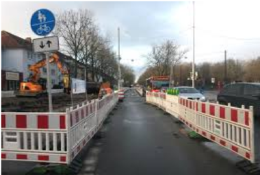
Bild 3 Beispiel einer Absperrung mittels Absperrschranken
