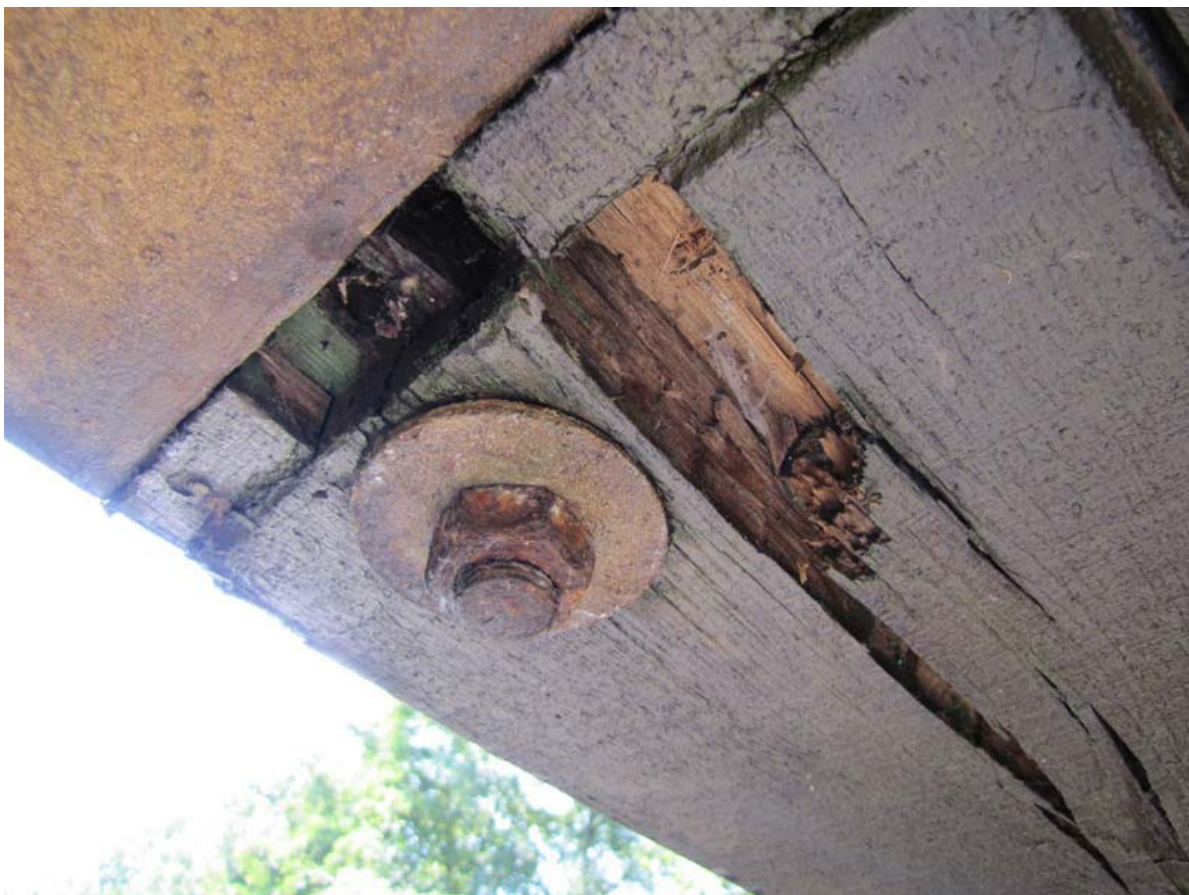
Bild 15: Zustand des Hauptträgers unmittelbar am Knotenblech
