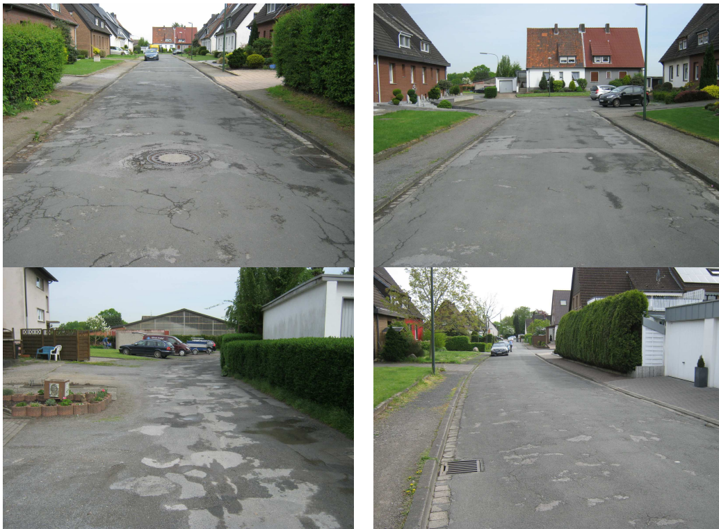
Abbildung 2: Fotos 1-4, Bestand „Am Freistuhl“, „Diebecker Weg“ (April 2018)
