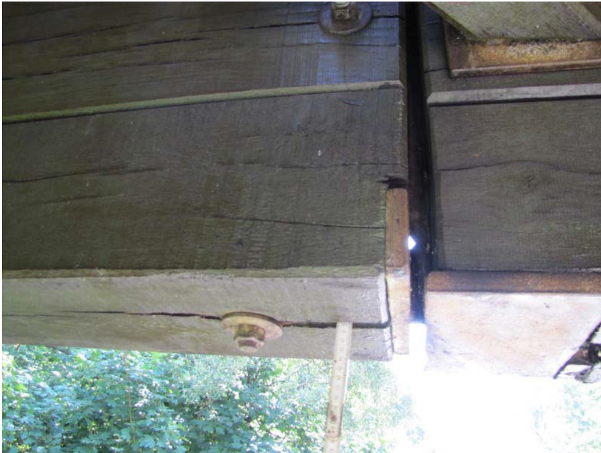
Bild 14: 30 Zentimeter tiefer Spalt im Bereich des Knotenbleches
