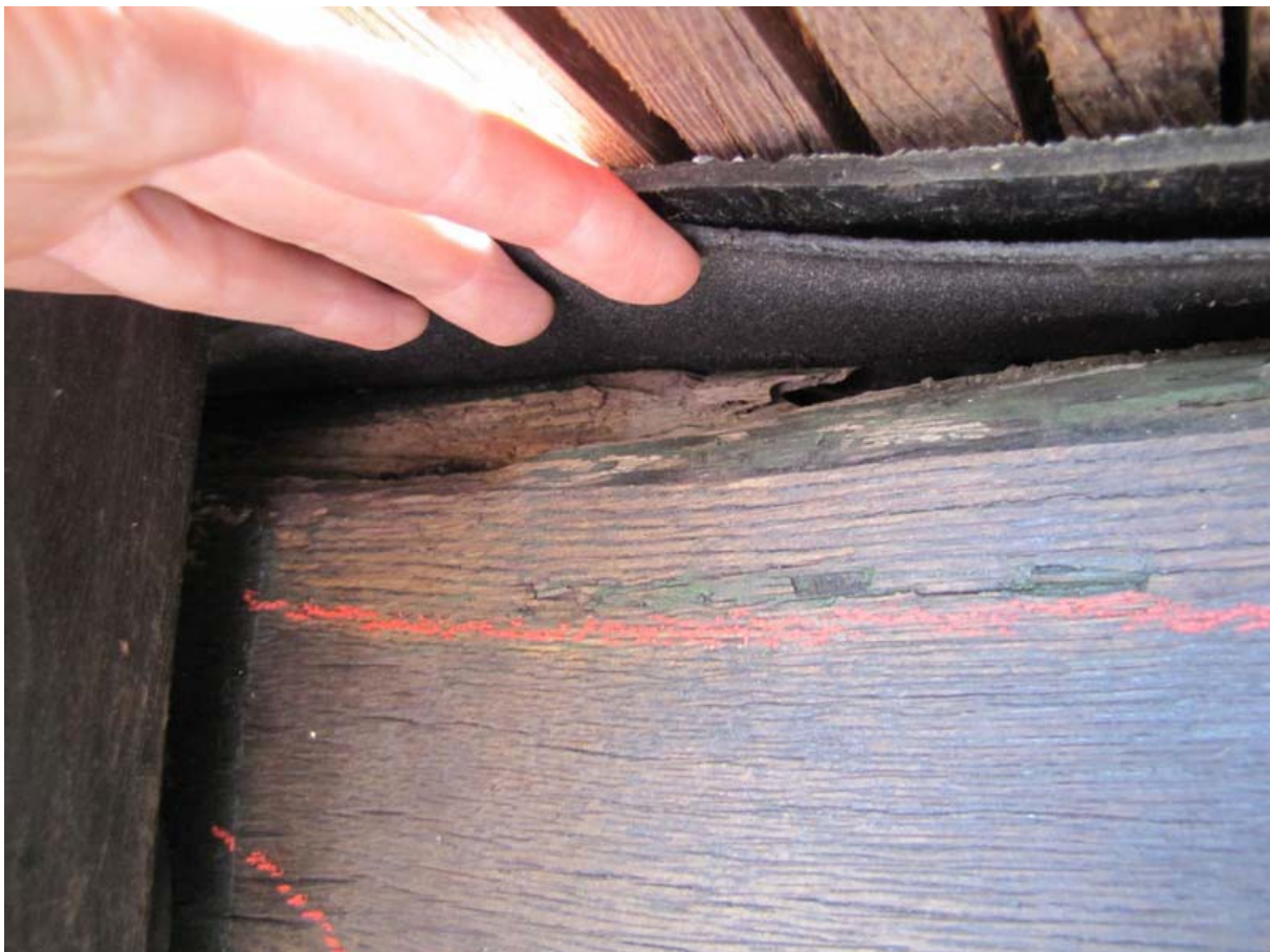
Bild 8: Unter der Abdeckung sind Fraßgänge erkennbar
