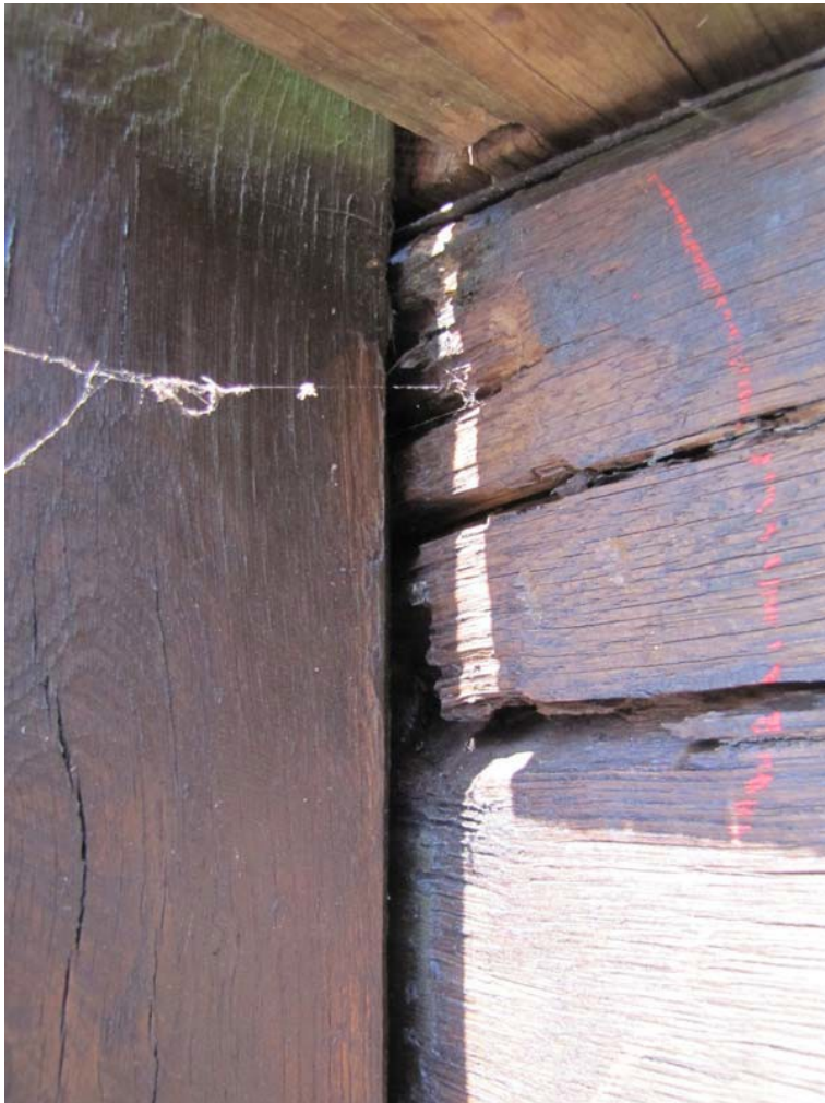
Bild 4: Deutlicher Substanzverlust im Bereich der Hauptträger an einem Pfosten
