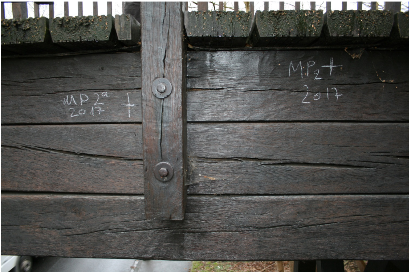
Bild 18: Lage der Bohrungen 2 und 2a (Kragarm, Richtung Innenfeld).
