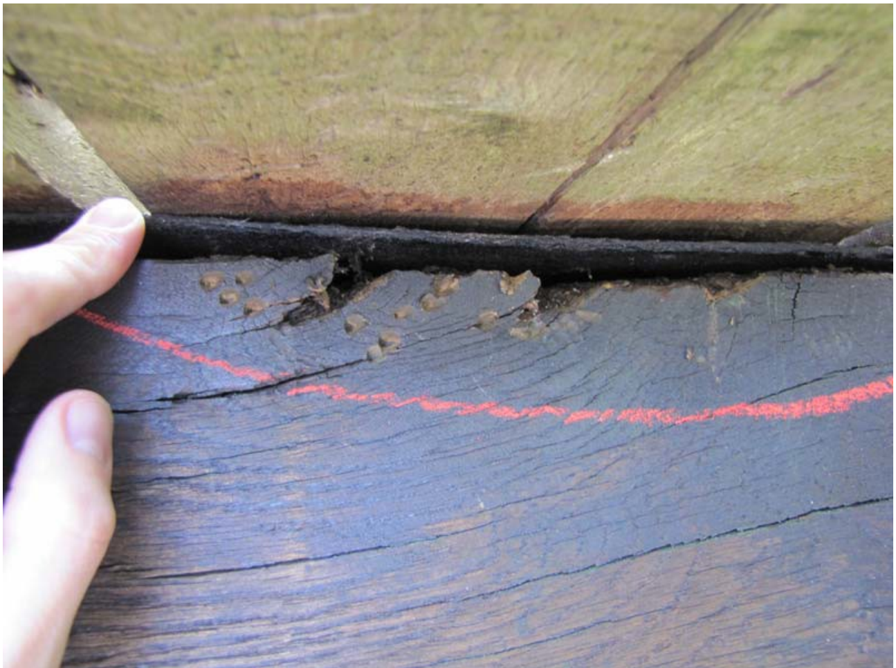
Bild 6: Substanzverluste an der Oberfläche des Längsträgers, die Ansichtsfläche ist nicht mehr scharfkantig aber ansonsten noch gesund (die Einkerbungen sind durch sondierende Hammerschläge entstanden)
