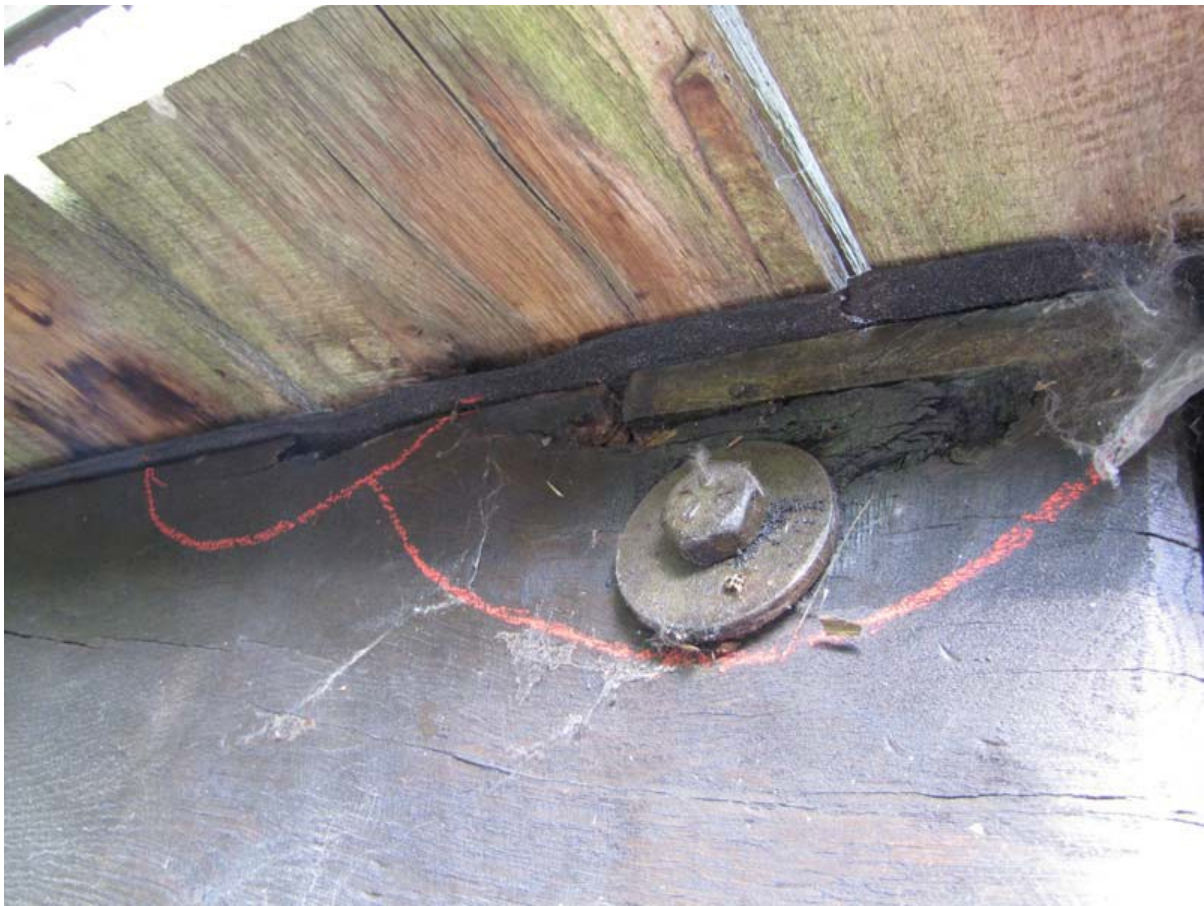
Bild 9: Schädigung der Oberfläche im Bereich des Knotenbleches
