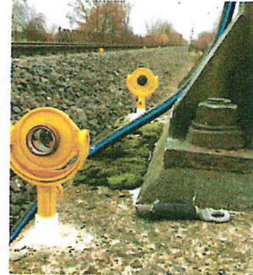
Aktive Messtechnik am Gleiskörper und Bahndamm
