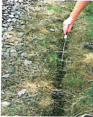
Rissbildung im Bahndamm
