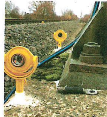
Aktive Messtechnik am Gleiskörper und Bahndamm
