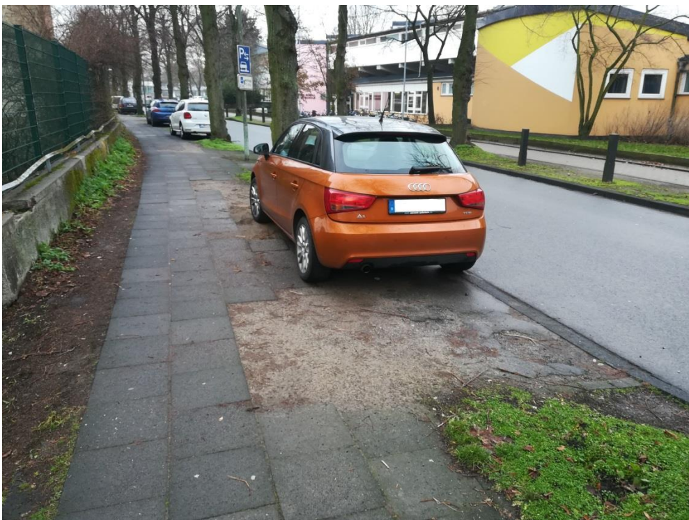
Bild 2: Gehwegschäden und instandgesetzte Teilflächen
